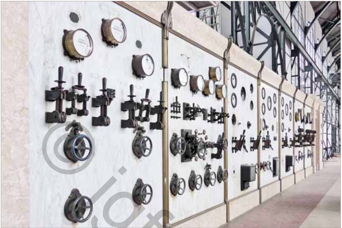
Schaltschrank, Zeche Zollern 2019
