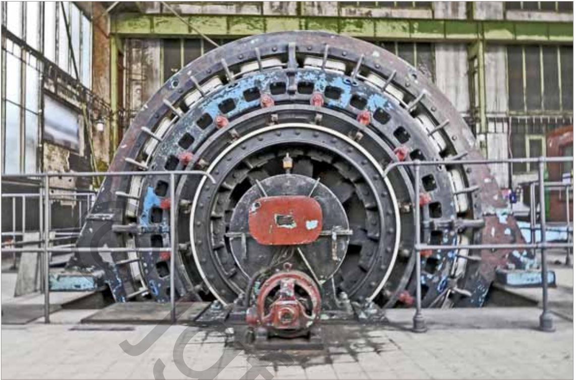
Förderantrieb, Ostrava Vitkovice/ CZ 2020
